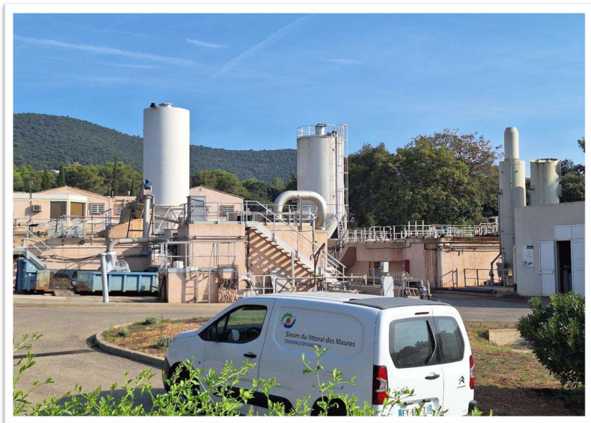
Station d'épuration intercommunale de Pardigon
