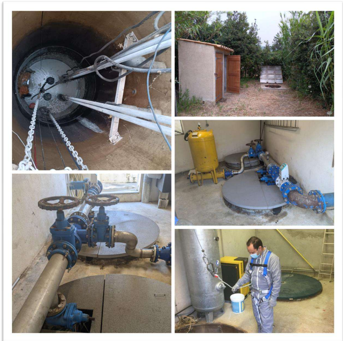
Postes de relevage de Moby Dick et de PR1 sur la commune de La Croix Valmer
