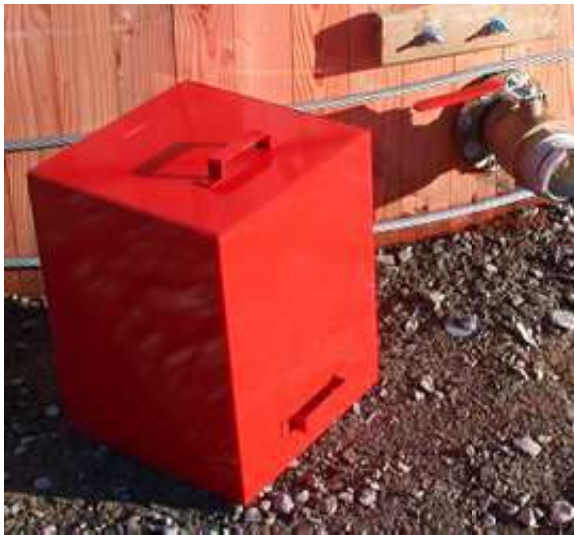
Prise directe de 100 mm sur réserve d'eau incendie aérienne
