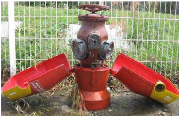
Poteau Incendie de 150 mm avec deux sorties de 100 mm et une sortie de 65 mm
