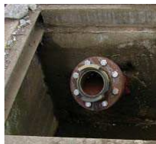
Bouche d'aspiration de 100 mm sur une réserve d'eau enterrée
