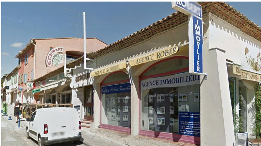
Enseigne scellée en façade ou sur store – Conforme à la RNP. Enseigne en drapeau qui dépasse la limite supérieure du mur – Non conforme à la RNP
