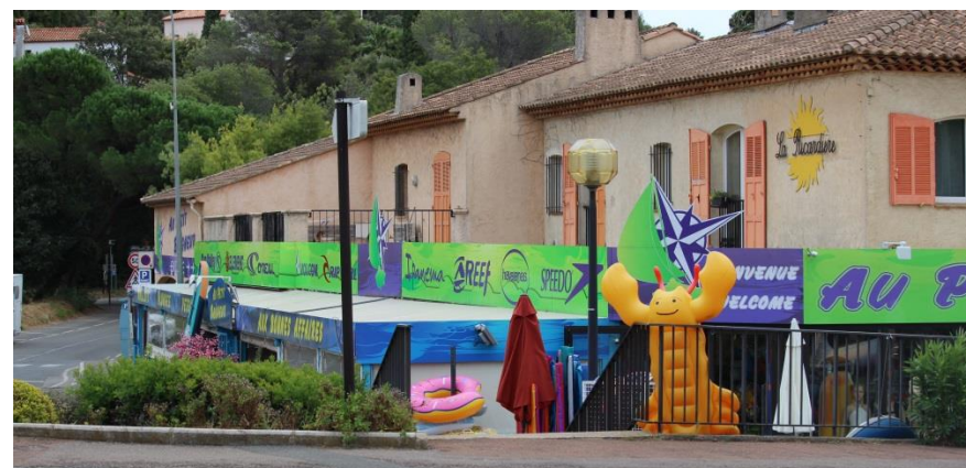
Enseigne à plat sur balcon – Non conforme en partie car supérieure à 1m de haut et dépassant la hauteur du garde-corps Si la superficie de la façade commerciale est supérieure à 50m 2 alors la superficie des enseignes ne doit pas dépasser 15% de la devanture.
